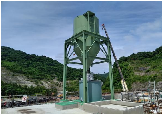
＜炭酸ソーダ貯留槽・溶解槽＞
