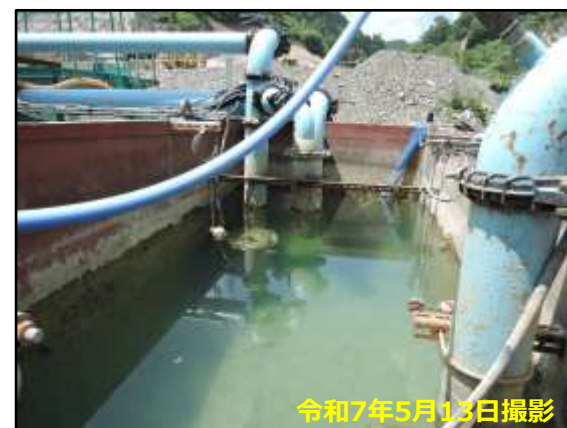
濁水処理プラント出口の水槽の状況
