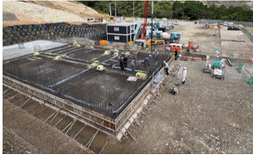
浸出水処理施設 地階
