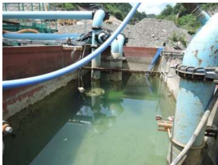
図 2.3-21 EC 変動濁水処理プラント内の状況（撮影日：R7.5.13）
