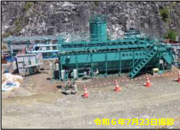
濁水処理プラント
