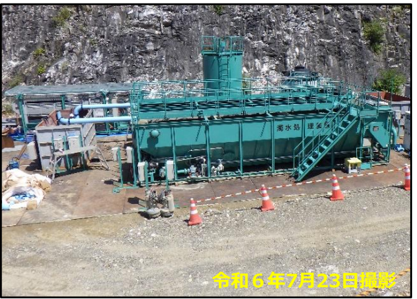
濁水処理プラント
