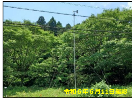
風向風速計 (③諏訪梅林増圧ポンプ場)
